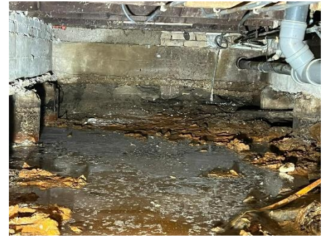
Schimmels in een kruipruimte
