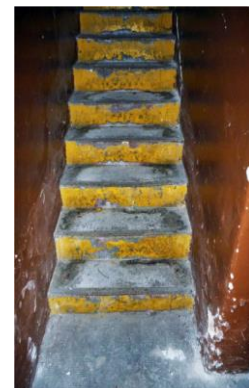
Polychlorobifyl (PCB)-bevallende betonverf
