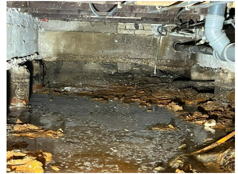
Schimmels in een kruipruimte
